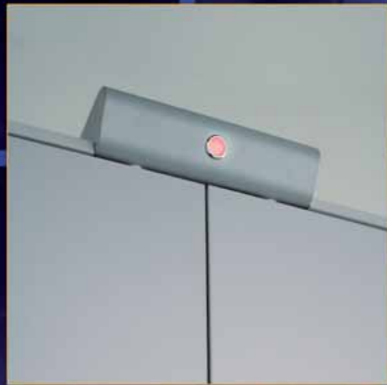
1. Un rilevatore di presenza a led tricolore, posizionato sul top dell'armadio, con funzioni di segnalatore acustico e di allarme.
